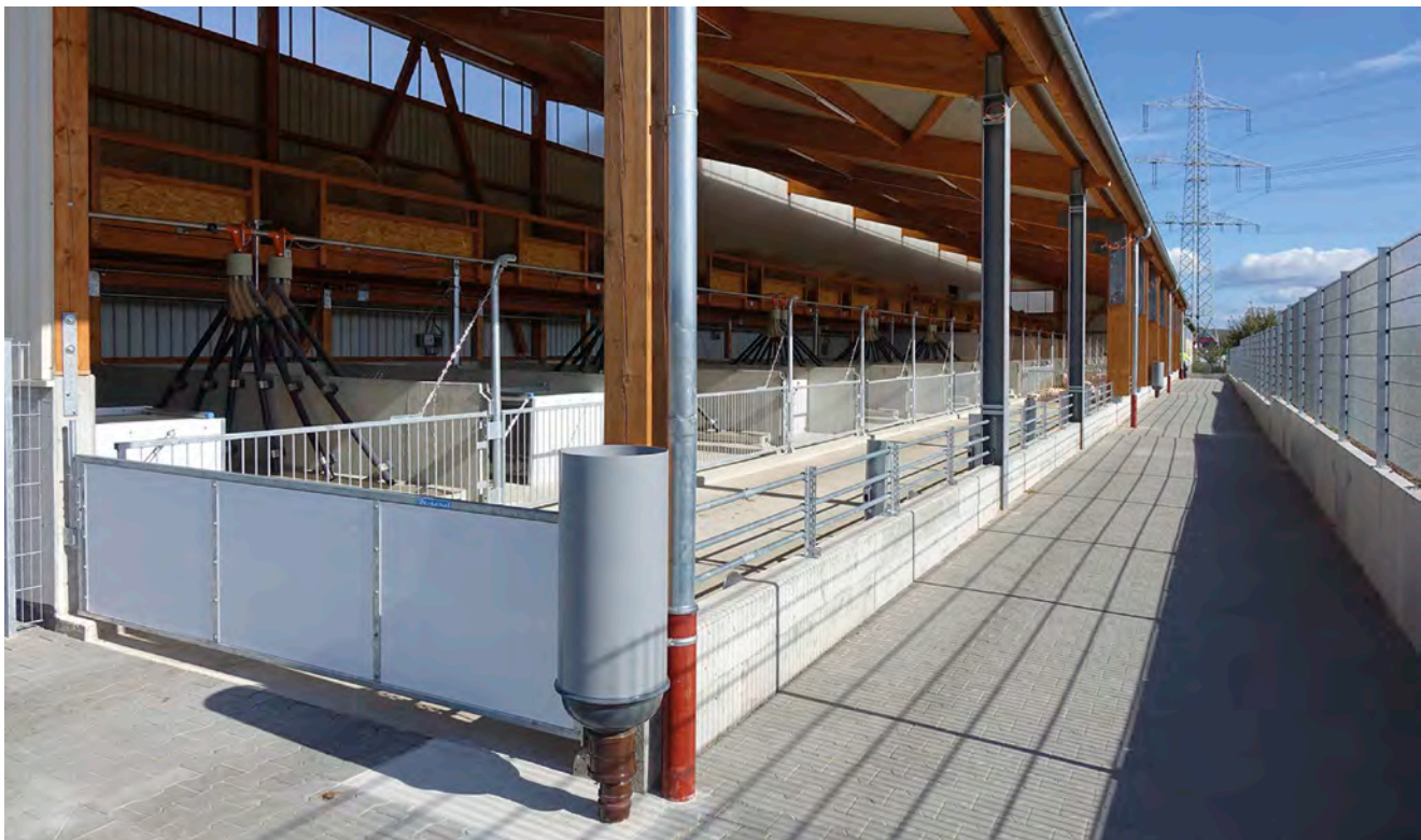
Rinnenspülung leicht gemacht: Auf dem Hof Denk wurde die rund 70 m lange Jaucherinne mit zwei Spülschächten mit einem Fassungsvermögen von jeweils 95 l ausgestattet. Foto: Funke Industrie
